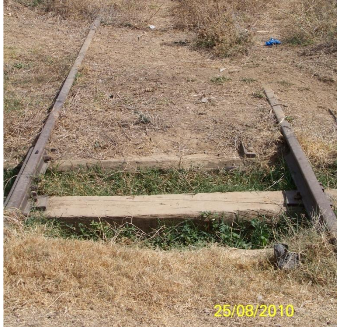
Şekil 5.71 Atıl durumda ve yer yer sökülmüş demiryolu hattı, Çivril şube hattı.
