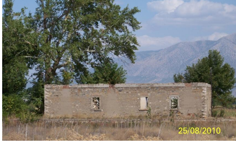
Şekil 5.70 Yangın geçirmiş ve harap olmuş yolcu bekleme idare yapısı, İnceköy Yerleşkesi, 2010.
