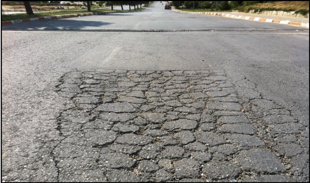
Şekil 5.4 Yorulma çatlağı (DEÜ Kampüs içi yolu).
