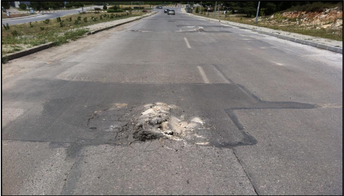
Şekil 5.3 Kabarma oluşumu (DEU Tınaztepe kampüs içi yol).
