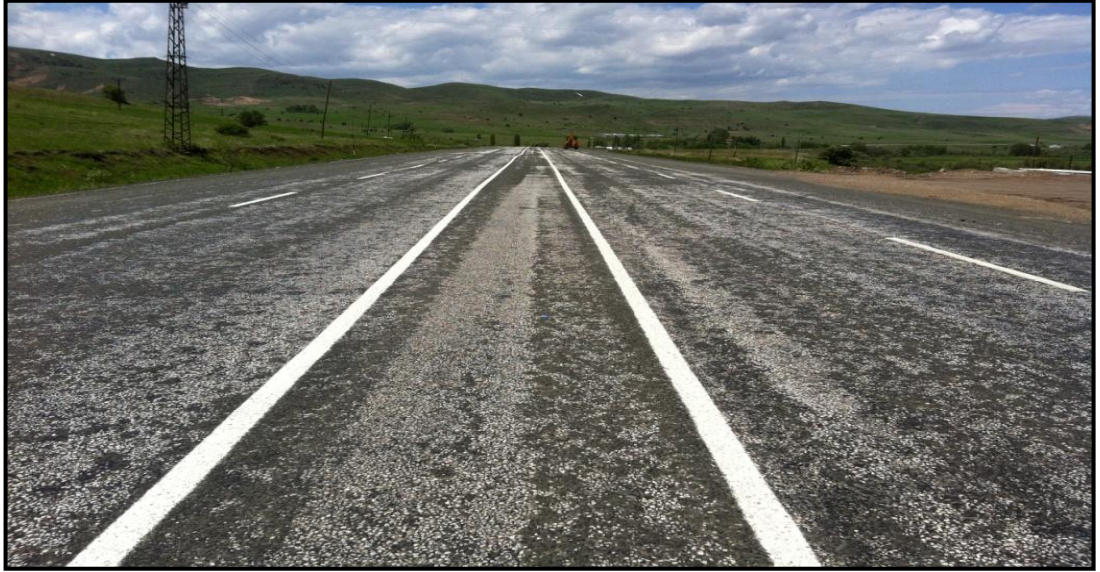
Şekil 5.7 Suya bağlı bozulma etkisi ile agrega danelerinin yol yüzeyinden ayrılması (Sivas-Erzincan yolu)
