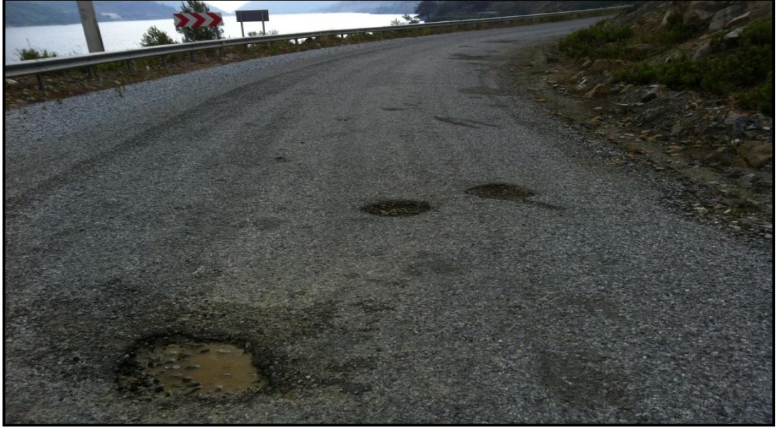
Şekil 5.6 Suya bağlı bozulma etkisi ile yol yüzeyinde çukur oluşumu (Alanya-Dim barajı yolu).
