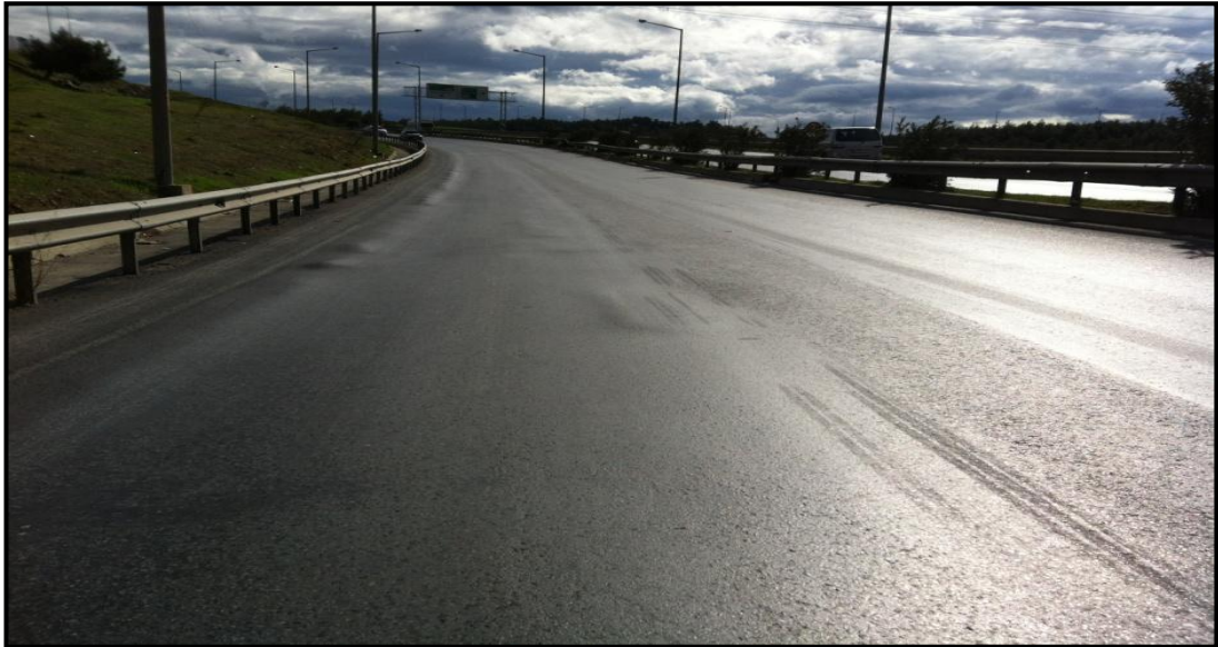
Şekil 5.1 Tekerlek izi oluşumu (İzmir çevreyolu Buca girişi).
