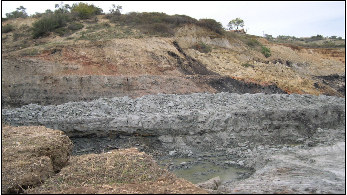
Foto 16: Bağıyaka Hafriyat Sahası Heyelan Risk Alanı
