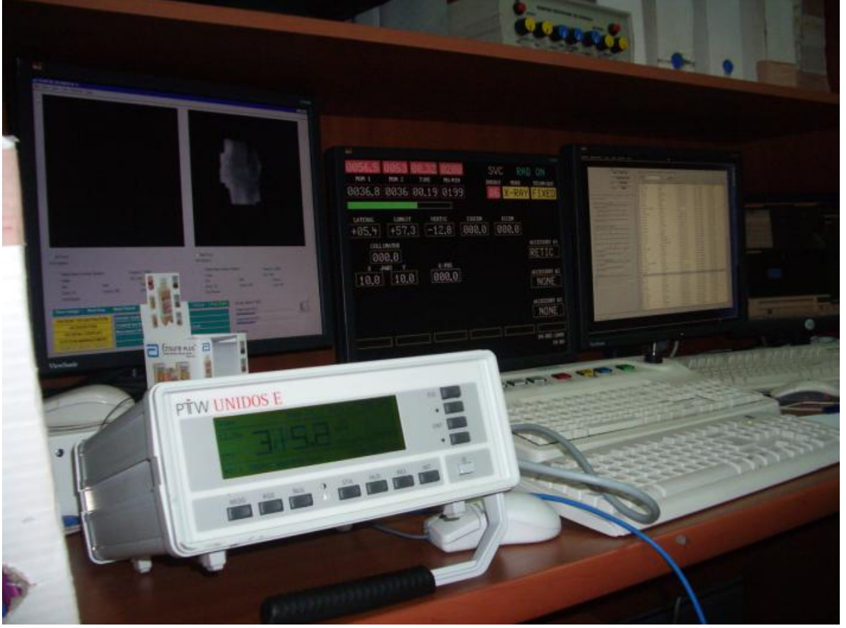
Şekil 3.19: Elektrometre ve Primus kontrol deski
