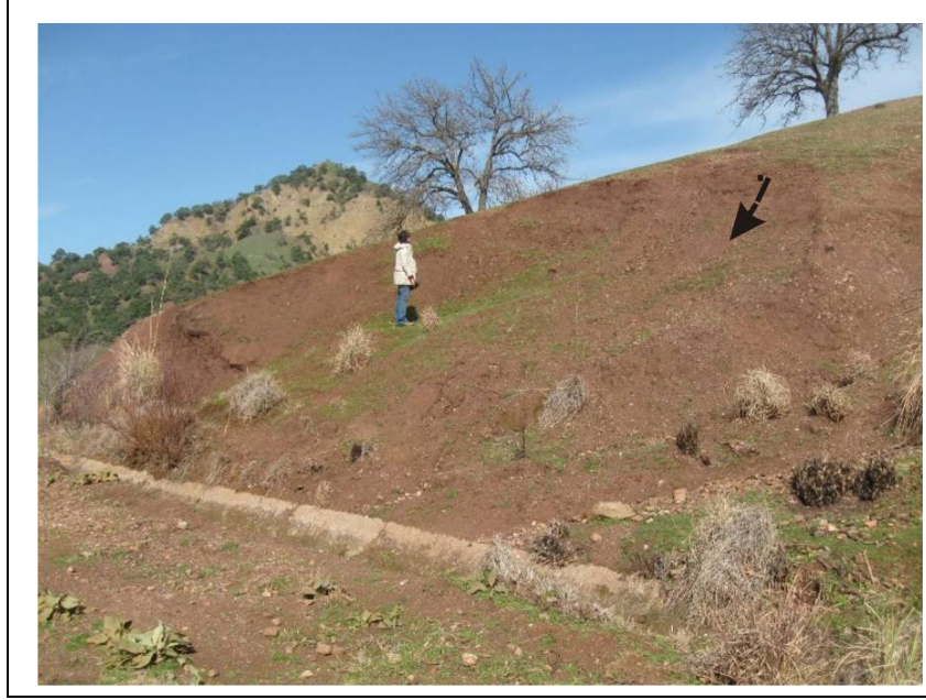
Şekil 3.42 Sağ Sahil aks yeri yakınında gözlenen kayma
