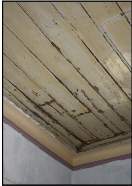
Şekil 5.193 Yapıya ait özgün ahşap tavan döşemesi.
