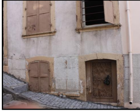
Şekil 6.23 Sokak sağlıklaştırma projesinde onarım görmüş yapı cephesinin durumu (121 ada, 84 parsel).
