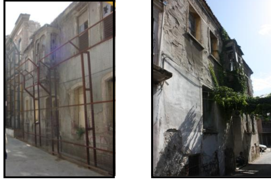
Şekil 6.5 Alan içindeki harap yapı örnekleri (178 ada, 67 parsel; 121 ada, 80 parsel).
