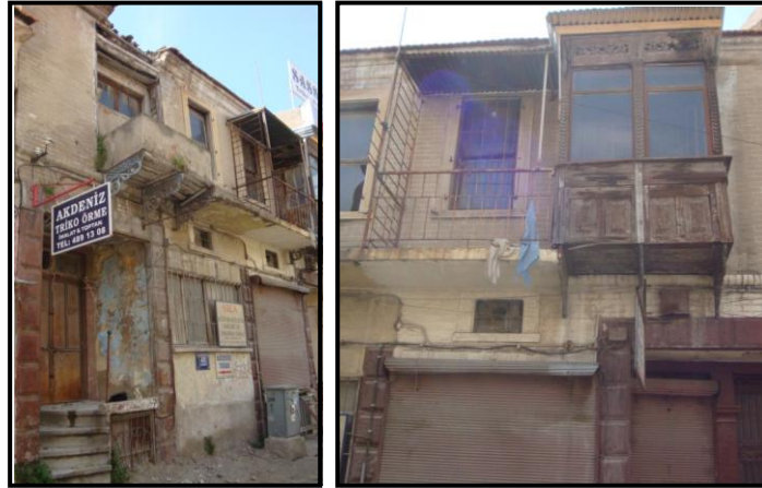
Şekil 6.21 442 Sokak'ta yer alan yapıda gerçekleştirilen niteliksiz müdahaleler.
