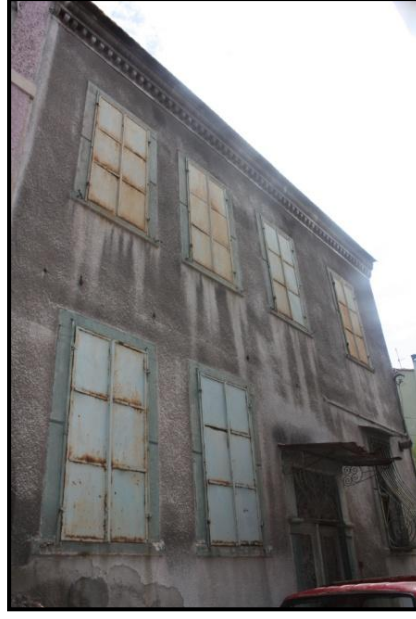
Şekil 5.206 Cephe üzerinde oluşan bozulma.
