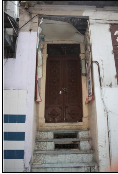
Şekil 5.68 Yapı girişinde oluşan harabiyet.
