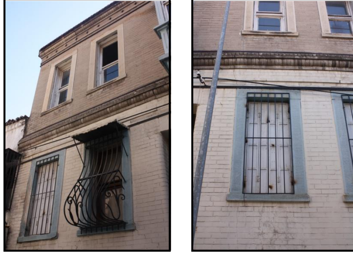
Şekil 5.245 Yapıda oluşan çatlaklar ve cephede yer alan niteliksiz ekler.
