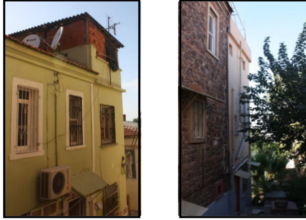
Şekil 6.16 Tescilli yapılara eklenen niteliksiz kütleler ve elemanlar (121 ada, 97- 93 parsel).
