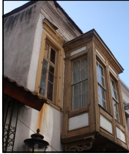
Şekil 5.282 Cephe elemanlarındaki bozulmalar.
