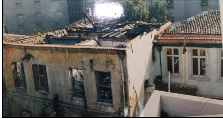
Şekil 5.12 Yapıların yangın sonrası 1987 yılında durumları (İzmir 1 No'lu KTVKKBK arşivi).
