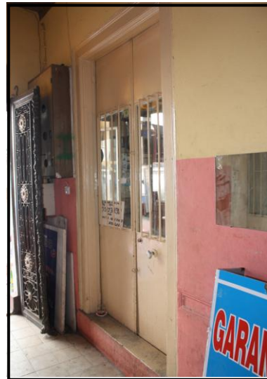
Şekil 5.22 Yapıya eklenmiş niteliksiz yapı elemanı.
