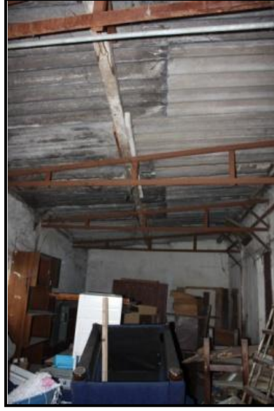
Şekil 5.239 Yapının süreç içerisinde aldığı niteliksiz ek.
