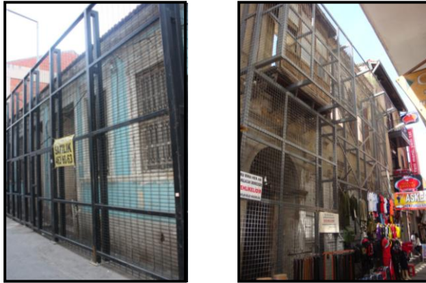
Şekil 6.22 Koruma kararı alınmasına rağmen uygulamaya başlanmamış yapı örnekleri (180 ada, 24-36 parsel).
