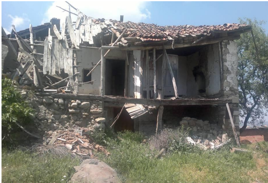
Őekil 5.8 Kayacık'ta geleneksel yapım teknik ve malzemeleri ile yapılmıř olan terk edilmiř harap bir yapı
