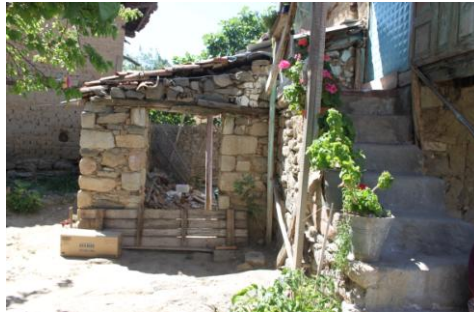
Avluda bulunan duvarları kısmen yıkılmış hayvan damı
