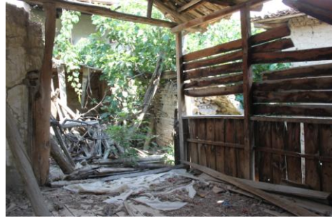
Kısmen yıkılmış dış sofadan genel görünüm
