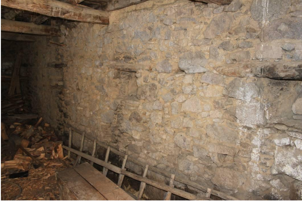
Şekil 4.41 Zemin kattaki depoda yan yana görülen dört adet havalandırmadeliği izi
