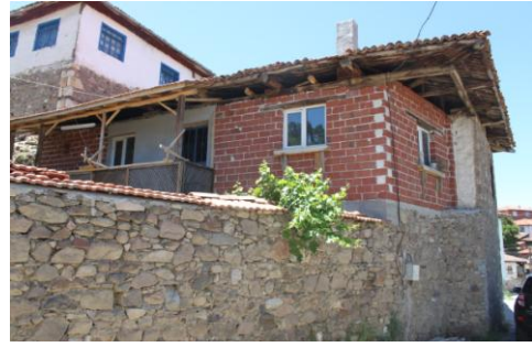
Ahşap korkulukları sökülmüş ve tuğla duvar örülerek kısmen kapatılmış sofa
