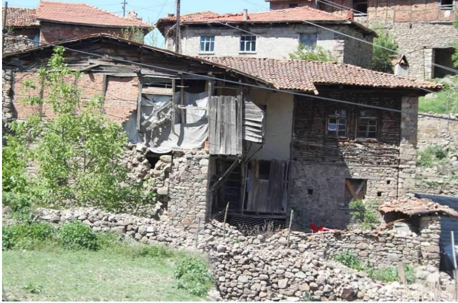
Őekil 5.7 Kayacık'ta geleneksel yapım teknik ve malzemeleri ile yapılmıř olan terk edilmiř harap bir yapı
